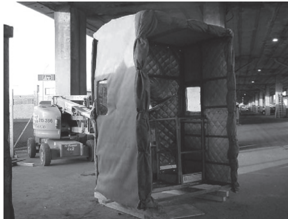
Figure 9.9-4 Écran sur nacelle, fait à partir de toiles acoustiques
